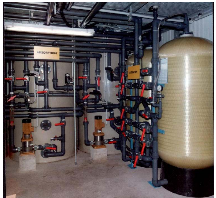
Blick auf die Filtrations- und Adsorptionsstufen im Untergeschoss.
