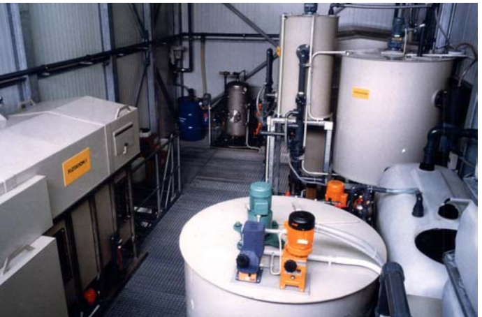
Blick auf die zwei Flotationsstufen im Obergeschoss.
